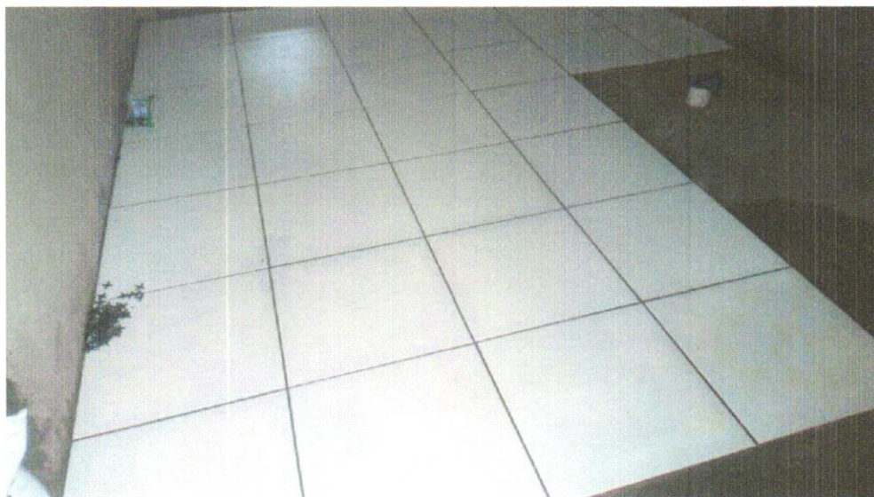
FOTO 9 - REVESTIMENTO CERÂMICO PARA PISO COM PLACAS TIPO ESMALTADA EXTRA DE DIMENSÕES 45X45 CM APLICADA EM AMBIENTES DE AREA MAIOR QUE 10M2 AF 06/2014
